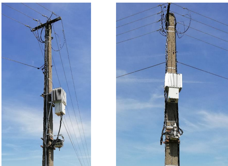
Rys. 7.23. Przykładowa realizacja symetryzatora transformatorowego przyłączonego w punkcie N2 obwodu niskiego napięcia zasilanego ze stacji transformatorowej SN/nN „Y”
