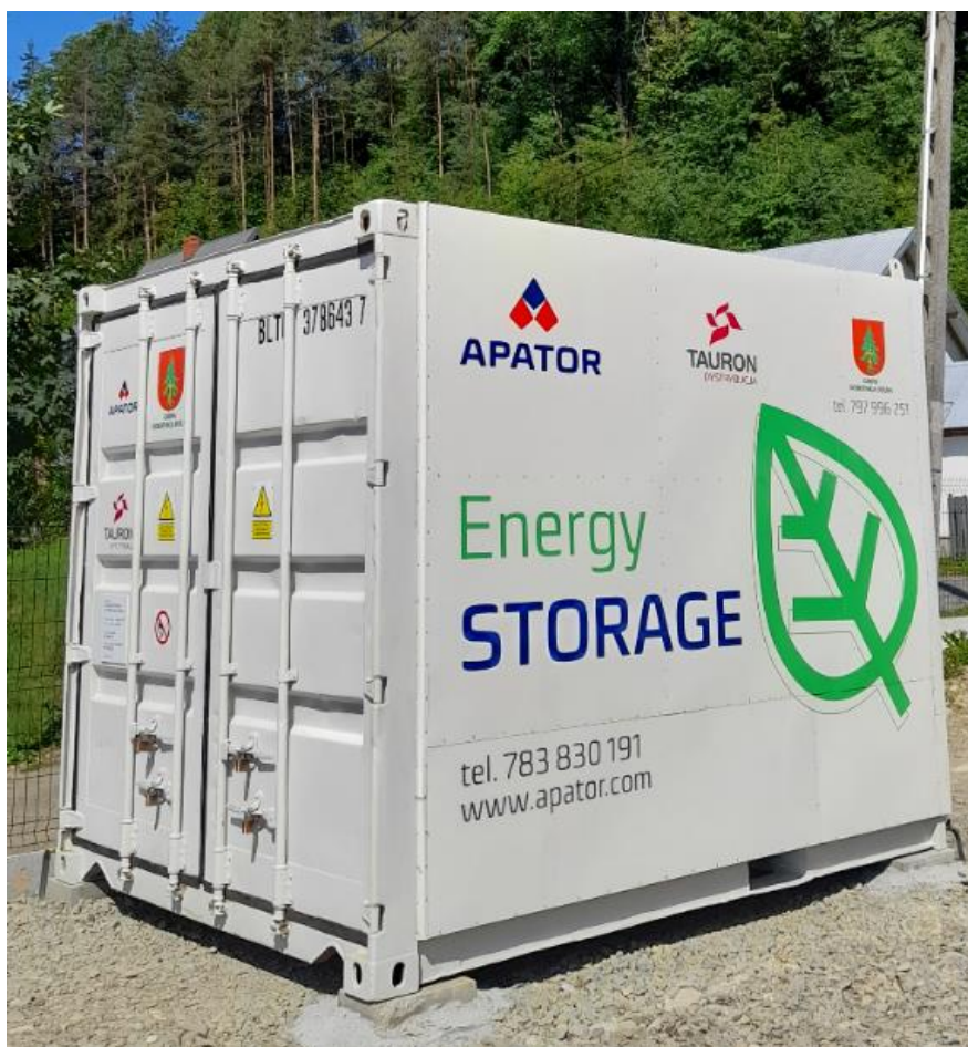
Rys. 7.29. Widok bateryjnego magazynu energii przyłączonego w punkcie M11 obwodu niskiego napięcia zasilanego ze stacji transformatorowej SN/nN „X”
